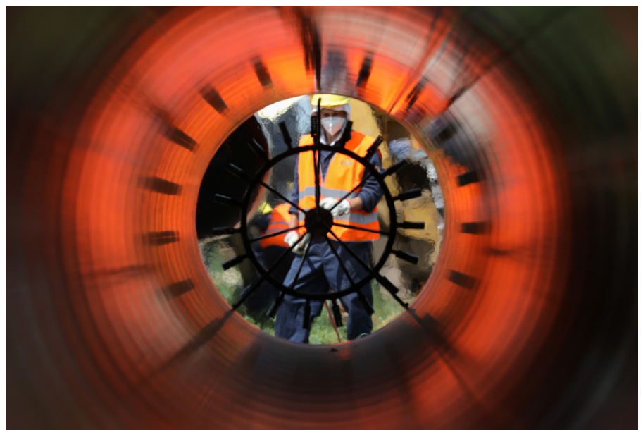
Arbeiter sind durch ein Rohr auf einer Baustelle für die Erweiterung der russischen TurkStream-Gaspipeline in Bulgarien im Juni 2020 zu sehen. Stoyan Nenov / Reuters
